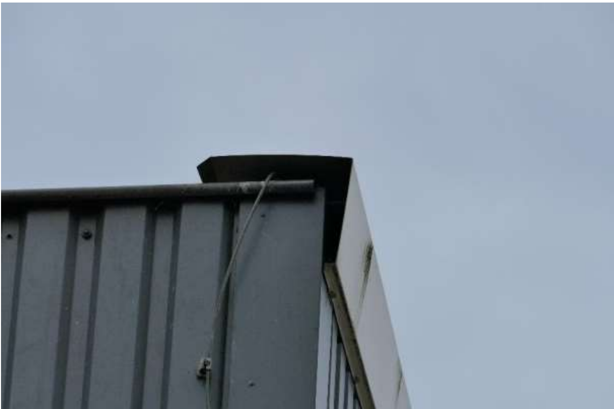
Figuur 4.4 Bij de dakrand van de schuur zijn enkele spleten aanwezig.
